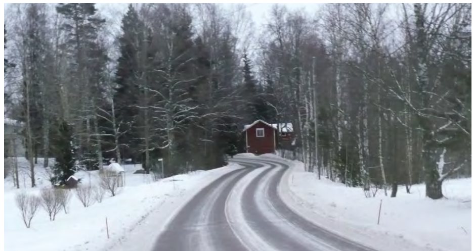
Kuva 3. Kuvasta voidaan havainnoida Pornaistentielle tyypillistä geometriaa ja kuvan edessä routavaurio.
