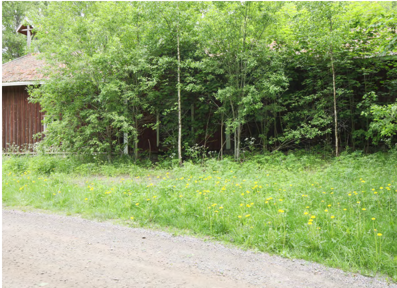
← Makasiinirakennuksen eteläisivun itäosa on paljolti kasvillisuuden peitossa.
