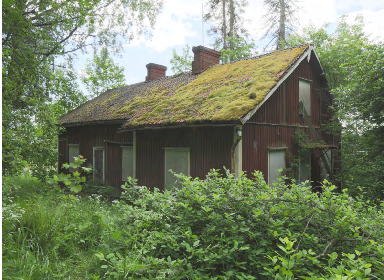
← Autioitunut asuin- ja saunarakennus, pohjoisen ja lännen puoleiset julkisivut.
