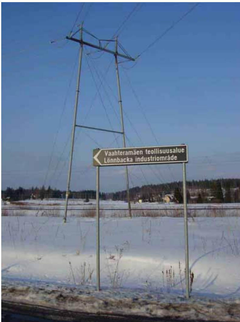
Bild 9 Elledning, 110 kV, som går genom området
