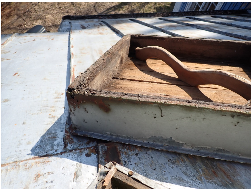
Kattopelleissä on ruostetta. Kattoluukun reunalaudat ovat lahonneet.
