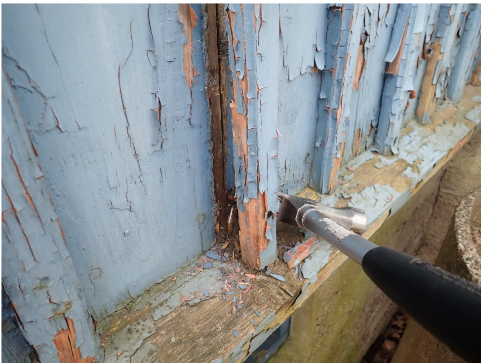
Julkisivulaudoitus on ponttilautaa. Rimojen takana ei ole tuuletusrakoa, vaan ponttilautojen saumat. Vaikka rimat ja laudat näyttävätkin huonoilta, ne ovat pääosin kunnossa alapäiden lievää haristumista lukuun ottamatta.
