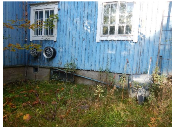
Kuva 44. Helmalaudoitus on lahovaurioitunut.
