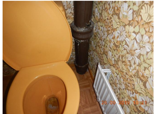
Kuva 96. Alkuperäinen valurautainen tuuletusviemäri yläkerran WC-tilassa
