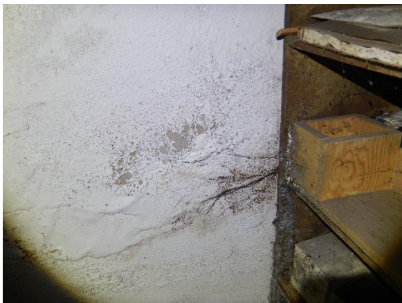
Kuva 28. Lahottajasienien rihmastoa kellarin seinässä.
