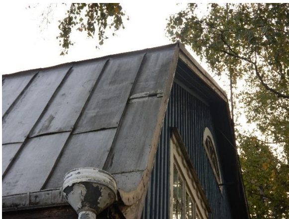
Kuva 66. Palapeltikatteen sauman limitys on auennut.
