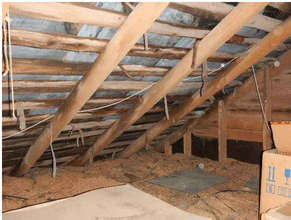
Kuva 34. Yläpohjatilassa on runsaasti roskaa. Kattoruoteissa on kosteusjälkiä.
