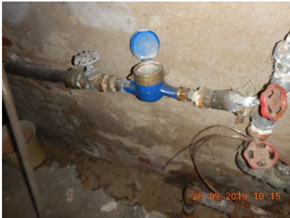
Kuva 99. Tonttivesijohto ja vesimittari
