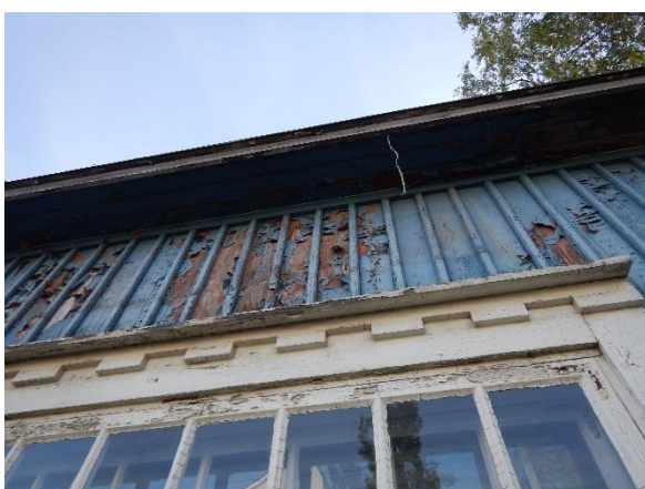
Kuva 49. Maalipinnoite lehteilee myös ulkoseinien yläosissa.
