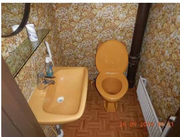
Kuva 101. Yläkerran WC-tilan vesi- ja viemärikalusteita
