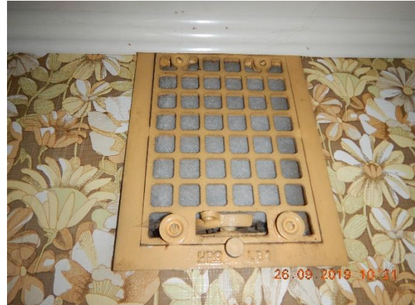
Kuva 106. Poistoilmasäleikkö jossa suodatinkangas
