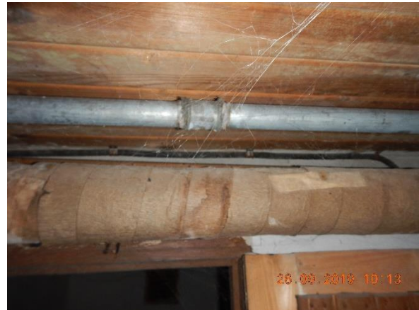
Kuva 100. Kylmävesijohto sinkittyä teräsputkea
