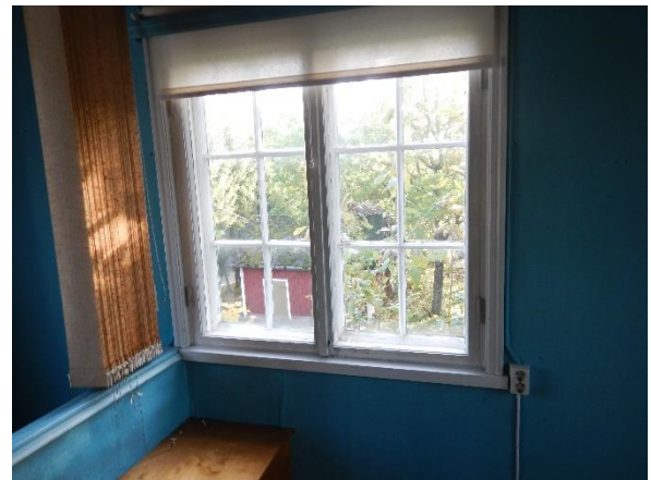
Kuva 57. Ikkunoiden sisäpuutteet ovat yksilasisia.
