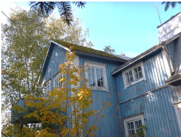
Kuva 64. Harjakatolla on runsaasti sammalkasvustoa.
