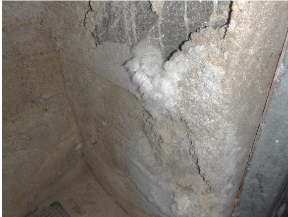
Kuva 26. Suolakertymää kellarin kantavissa betonirakenteissa.
