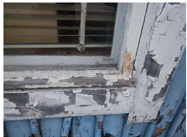
Kuva 53. Ikkunoiden maalipinta lehtelee merkittävästi. Puitteissa on paikoin havaittavissa lahovaurioita.
