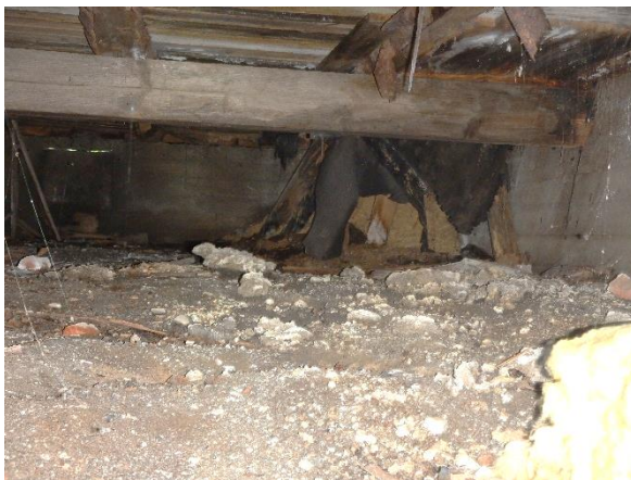
Kuva 20. Alapohjarakenne on lahovaurion vuoksi romahtanut.
