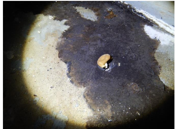
Kuva 25. Sienikasvustoa kellarin lattialla.
