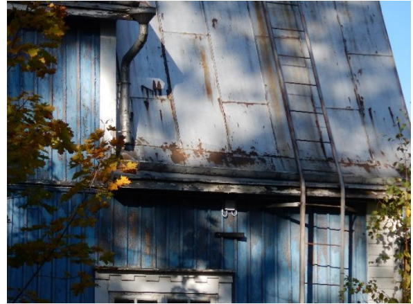
Kuva 63. Vesikatteen pinnassa on runsaasti ruostetta.
