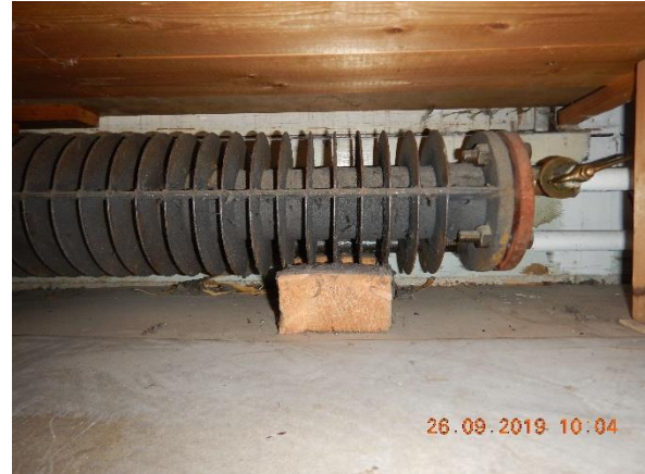
Kuva 94. Valurautainen ripaputkipatteri ja venttiili
