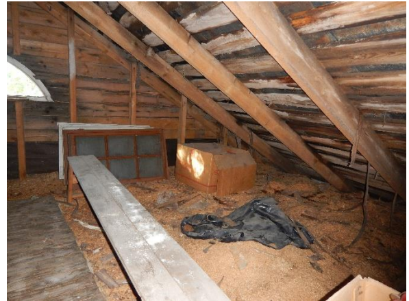
Kuva 33. Vesikaton puurakenteissa on kosteusjälkiä.
