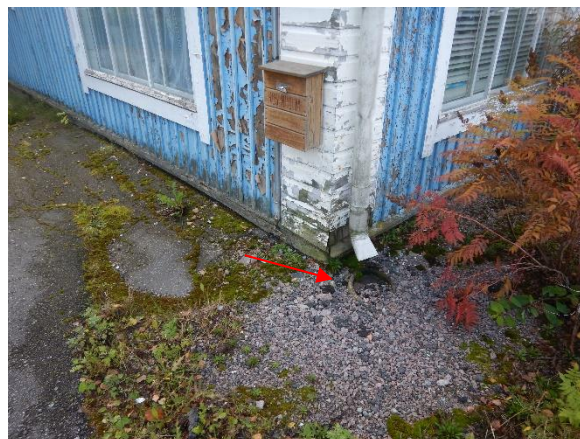
Kuva 12. Sadevesikaivo on osittain päällysteiden alla.
