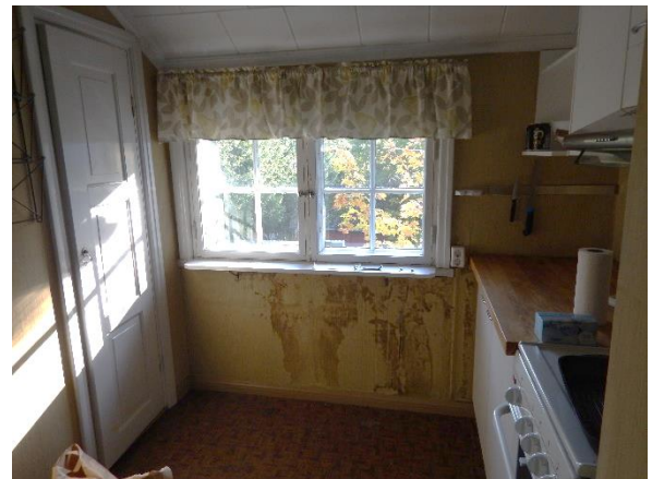
Kuva 82. Toisen kerroksen ikkunan alapuolella on havaittavissa vesivuotojälkiä.
