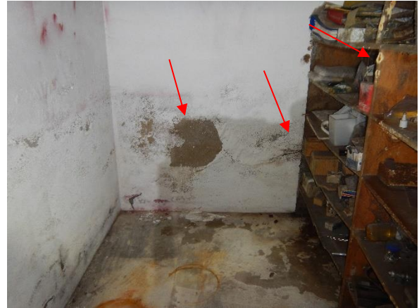
Kuva 27. Kellarin varastohuoneessa havaittiin aktiivinen lahottajasienikasvusto. Seinissä sekä puisessa hyllyssä on havaittavissa sienien itiöemiä, jotka ovat itiöityneet.
