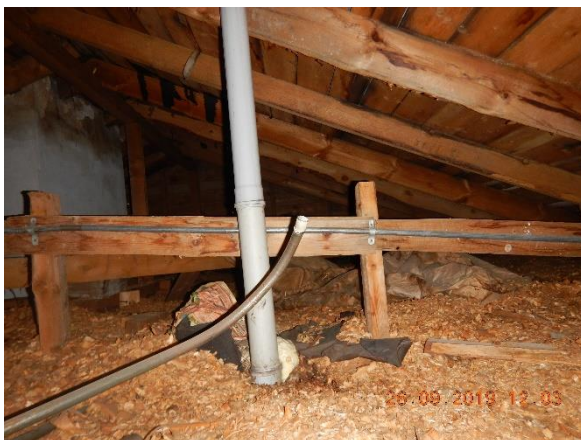
Kuva 81. Muovinen tuuletusviemäriputki yläpohjatilassa
