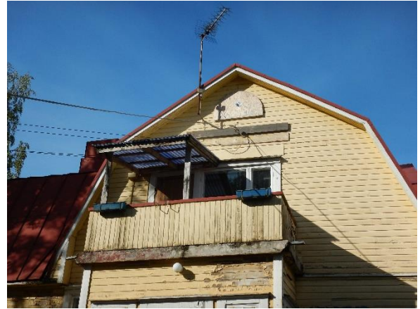
Kuva 8. Parvekkeelta katolta vesi valuu vapaasti sadevesikourusta.
