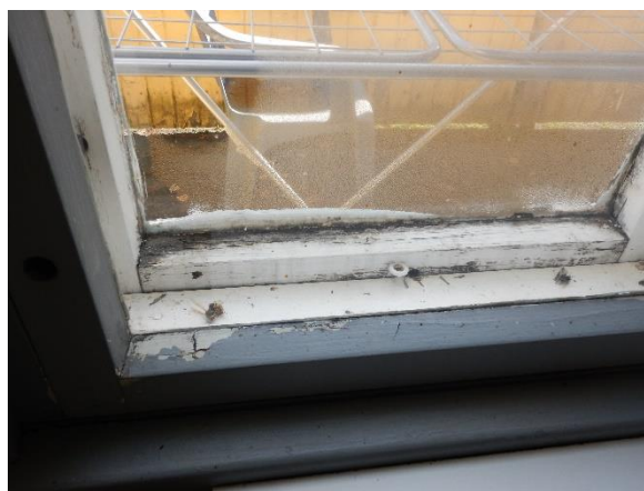
Kuva 45. Parvekkeen ikkunan ulkupuutteen sisäpinnalla on kosteusjälkiä.
