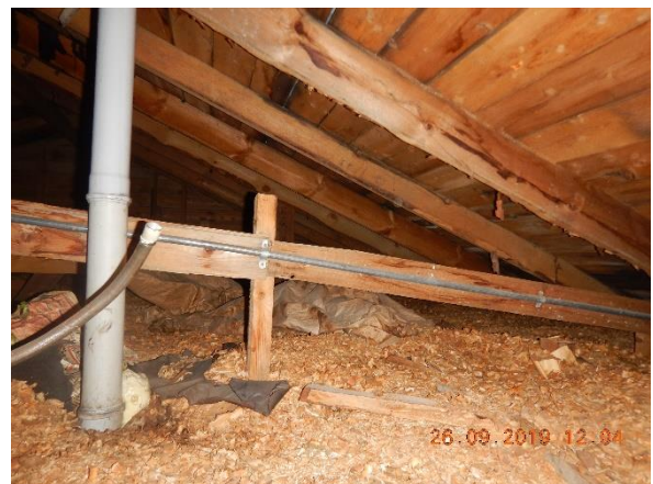
Kuva 23. Vuotojälkiä viemärin tuuletusputken läpiviennin kohdalla.
