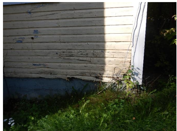
Kuva 29. Julkisivulaudoituksen alaosa on lahovaurioitunut rakennuksen itäpuolella.
