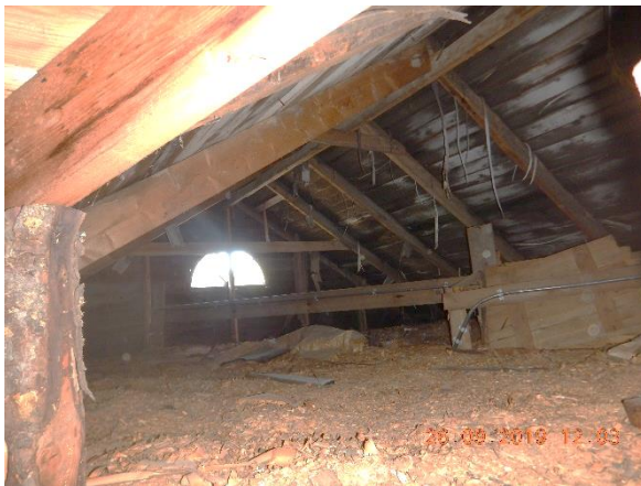
Kuva 20. Yleiskuva, yläpohja. Vesikaton puurakenteissa on vuotojälkiä.
