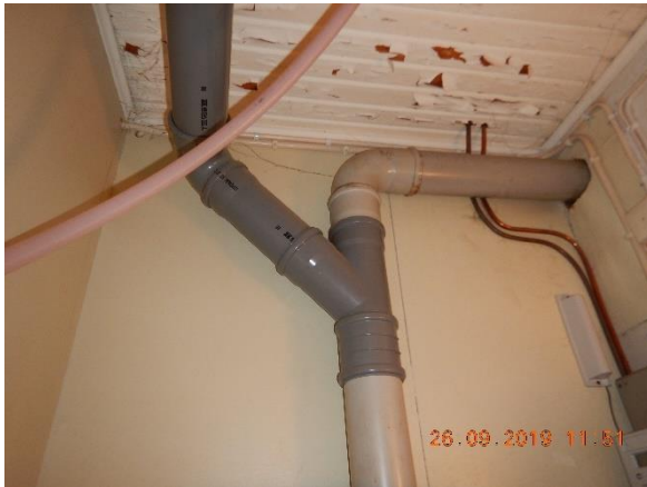
Kuva 79. Eri aikakausilla uusittuja muoviviemäreitä
