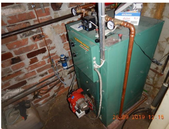
Kuva 73. Öljylämmityskattila ja poltin
