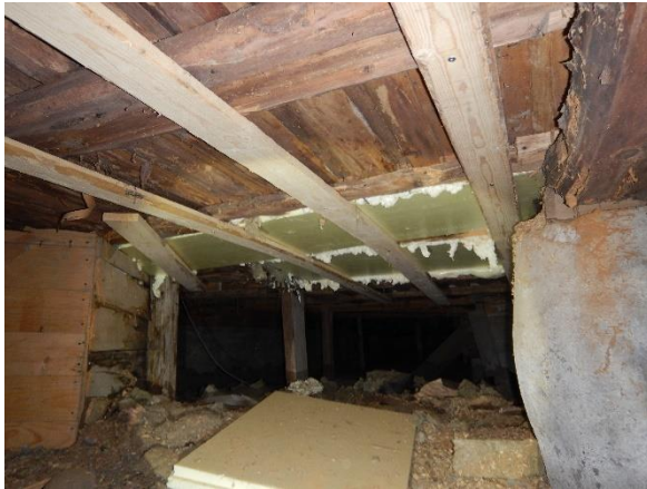
Kuva 17. Lahovaurioituneita alapohjarakenteita. WC-tilan kohdalle on asennettu eristelevyt.
