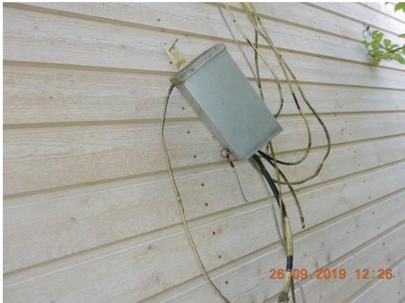
Kuva 100. KytKentärasia kiinnittämättä ulkoseinään.
