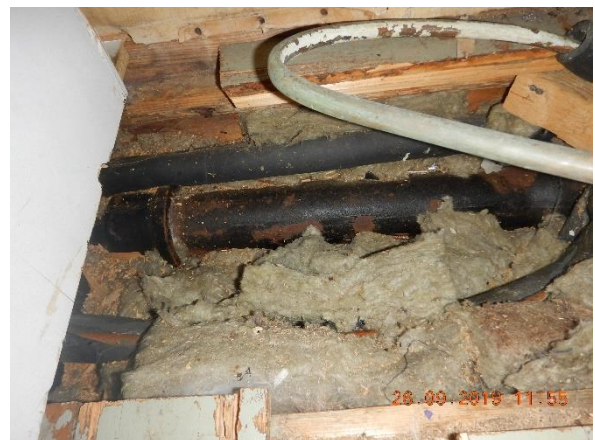
Kuva 82. Muhvillista valurautaviemäriä keittiön lattiassa
