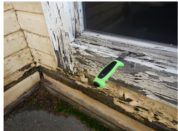
Kuva 41. Ikkunoiden alapuitteissa on lahovaurioita.
