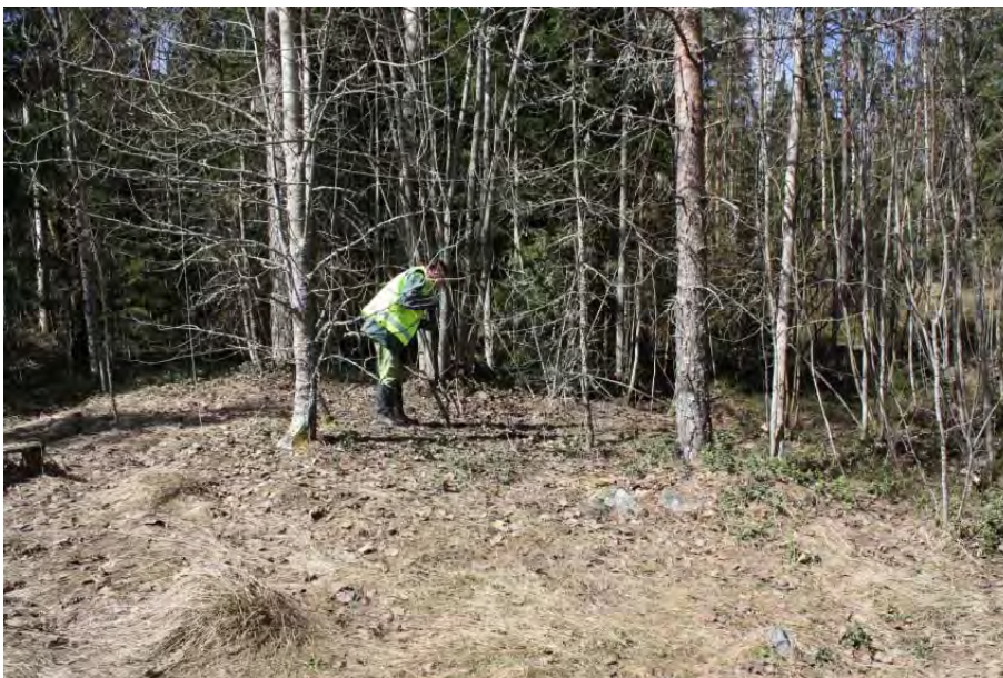
AKDG3152:7. Bulsin talon takana olevan kivijalan (Buls A) sisälle kaivetaan koekuoppaa. Kaakosta. Kuva: Petro Pesonen.
