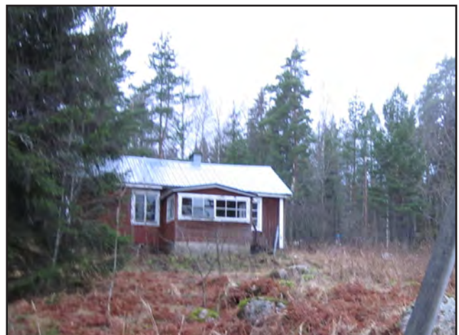
Purkukuntainen talo alueella. Hus i rivningsskick.
