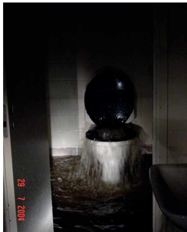
Figur 6. Toalettstolen i en källarvåning översvämmas i en översvämning i Riihimäki. (Egentliga Ta-vastlands räddningsverk 2004)
